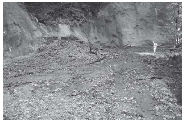
馬場地内の林道田代～椿線土砂崩落
