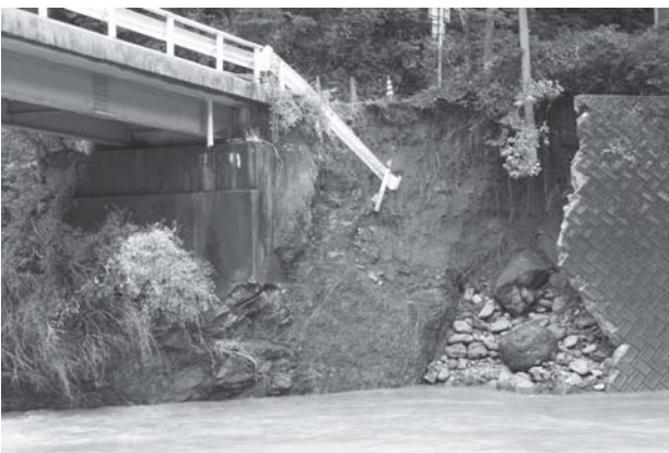
大室指地内の村道路肩決壊
