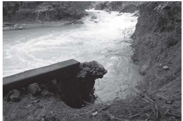
小善地地内の道志川護岸決壊
